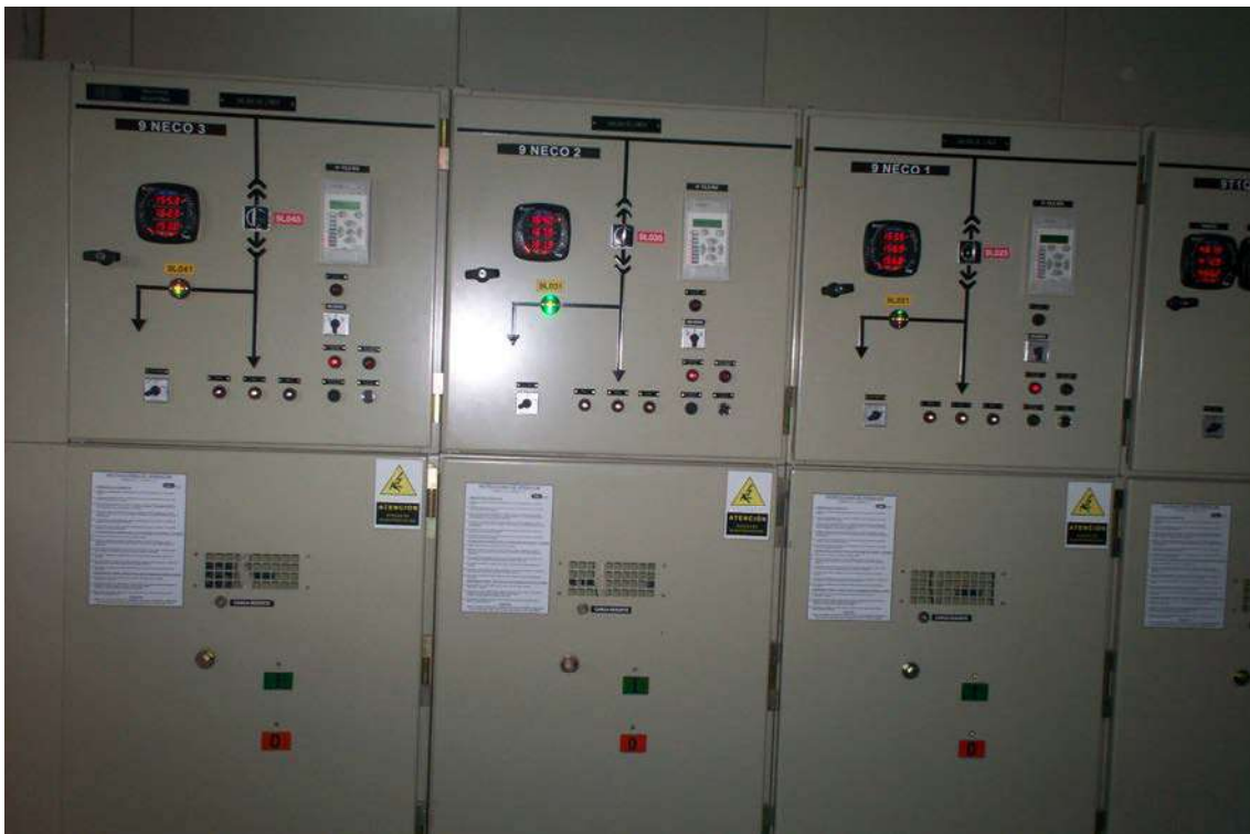
Fotografía 20. Vista de los tableros de comando de la sala de celdas 33 kV de la ET.
