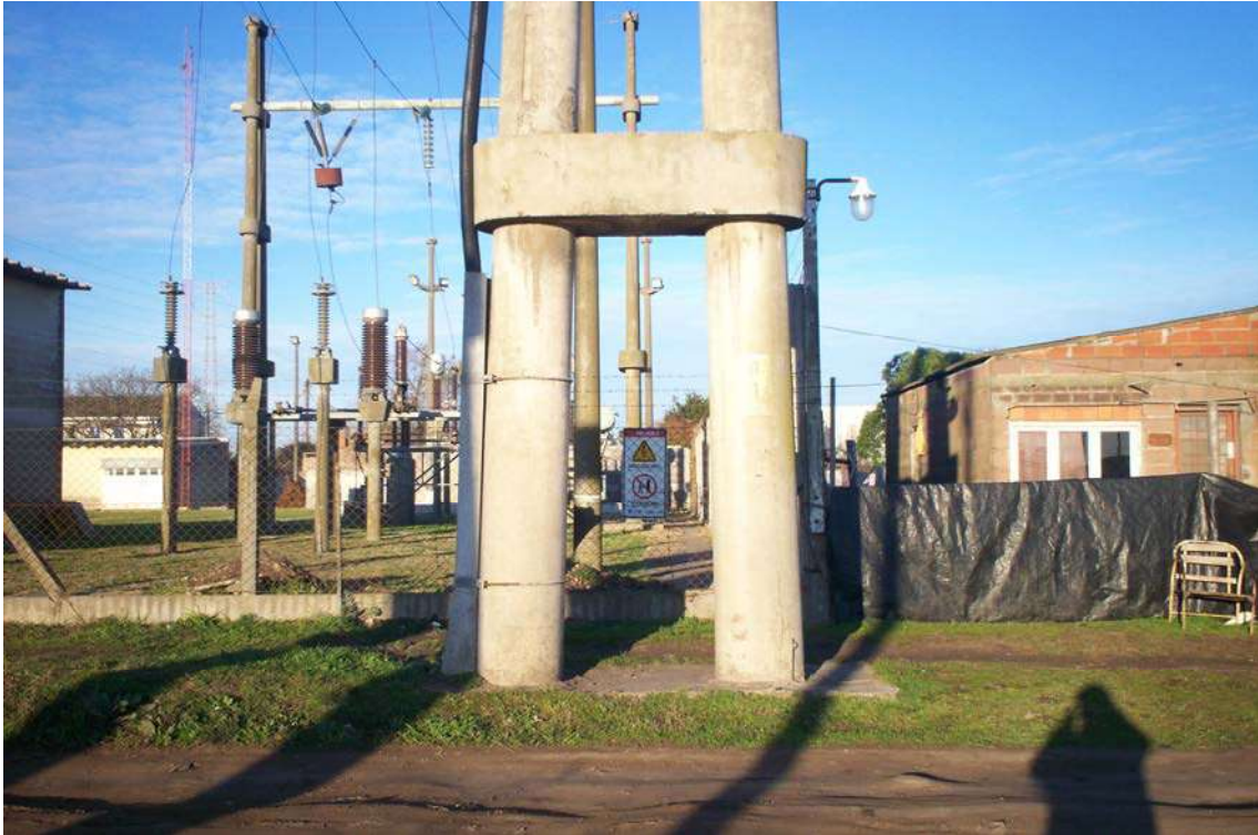
Fotografía 17. Vista del sector de vinculación de la ET a la LAT de 132 kV sobre calle. 529.
