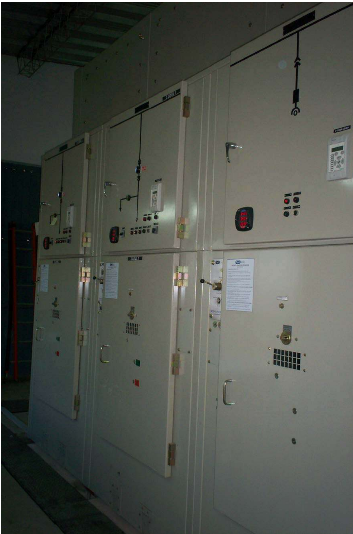
Fotografía 21. Vista de los tableros de comando de la sala de celdas 13 kV de la ET.
