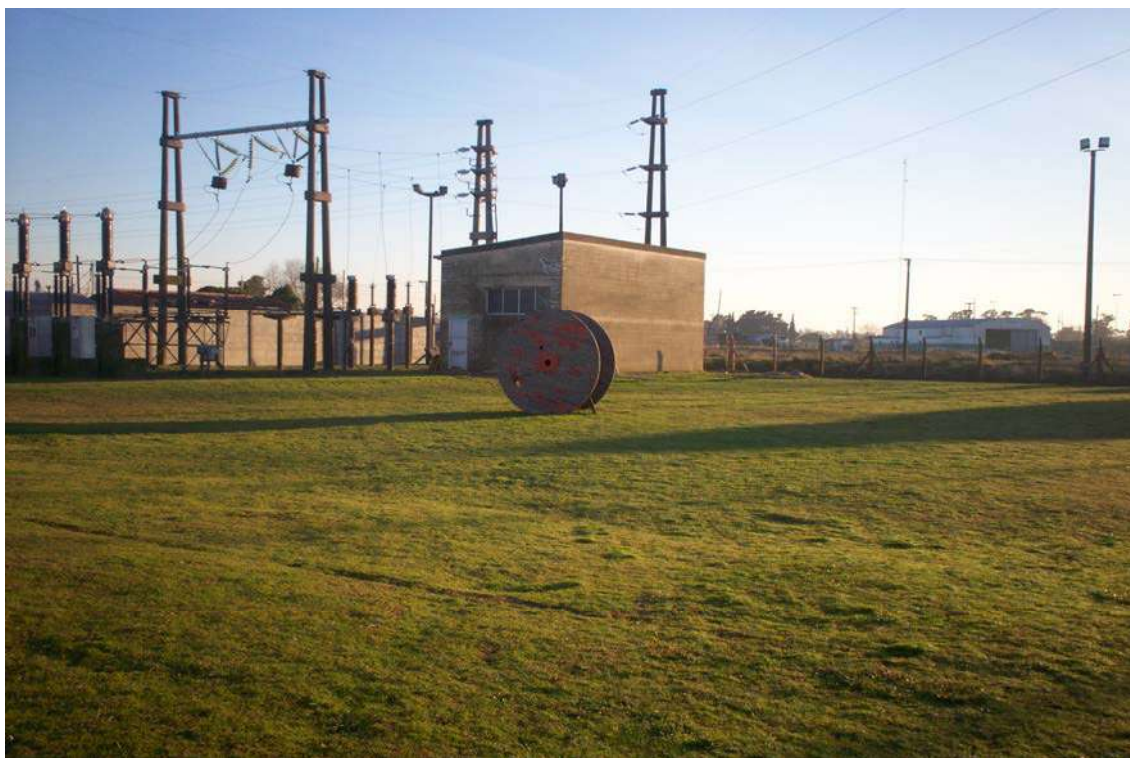
Fotografía 22. Vista de la sala de celdas 13 kV de la ET.
