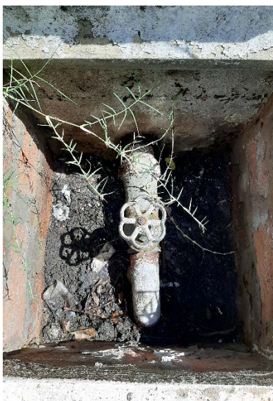
Llave esclusa entrada Tanque Cisterna
