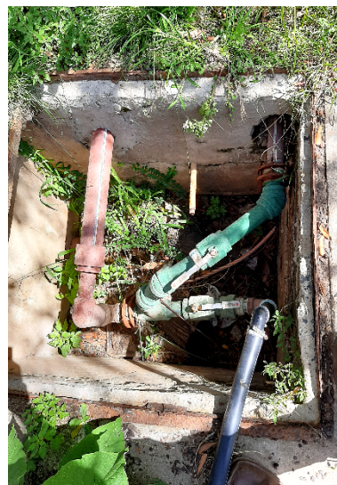
Cámara de derivación, salida Tanque Reserva
